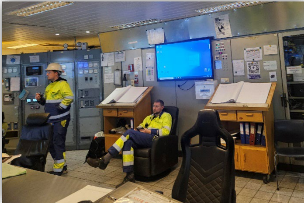
Fra kontrollrommet overvåkes smelteovnene. Det er kamera på flere kritiske punkt i prosessen.
